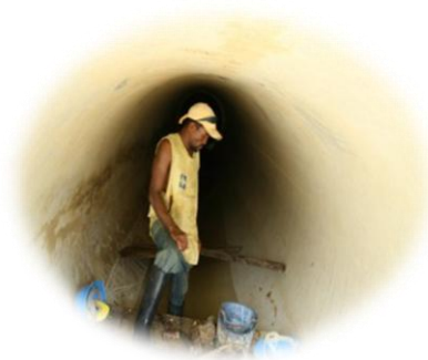
Foto No 3: Tramo de construcción de la tubería que transportará aguas residuales hasta el emisario submarino.
